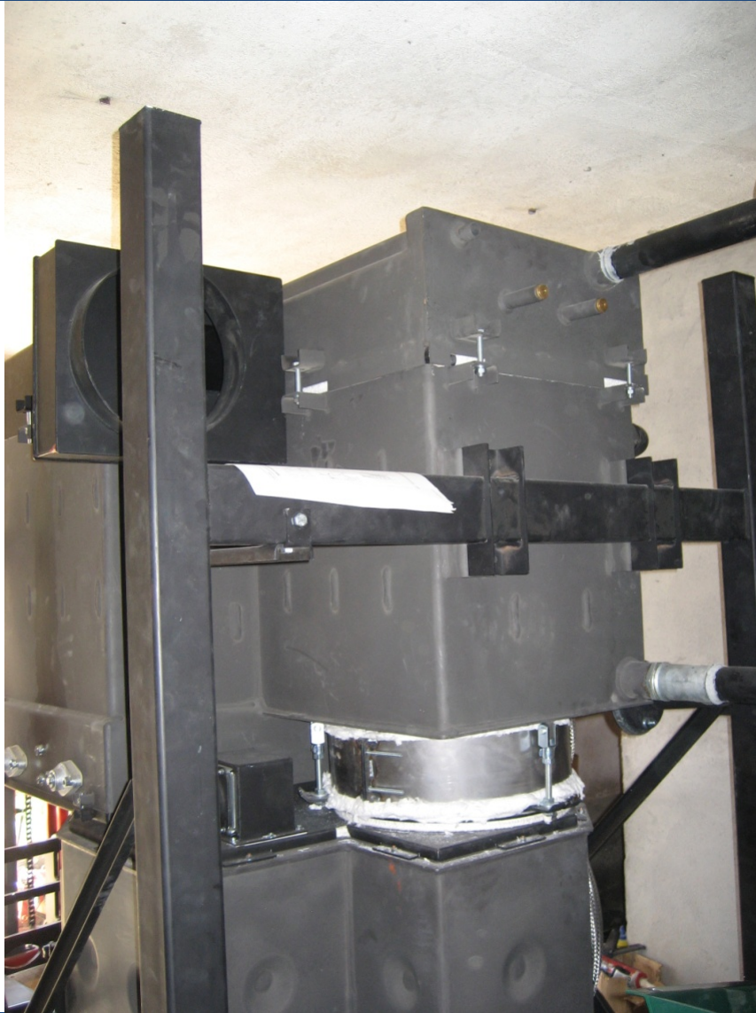
Caldera de biomasa
