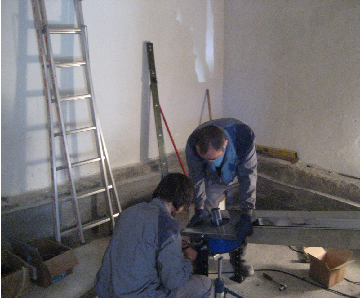
Preparación del sistema de entrada de pellets al sistema de alimentación automática
