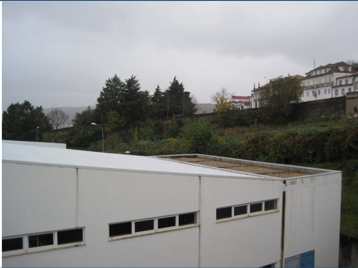
CUBIERTA PLANA SOBRE LA QUE SE COLOCARÁN 9 PANELES SOLARES
