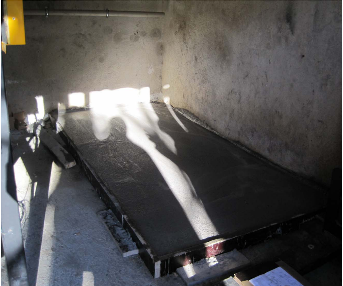
Bancada de cemento para los acumuladores
