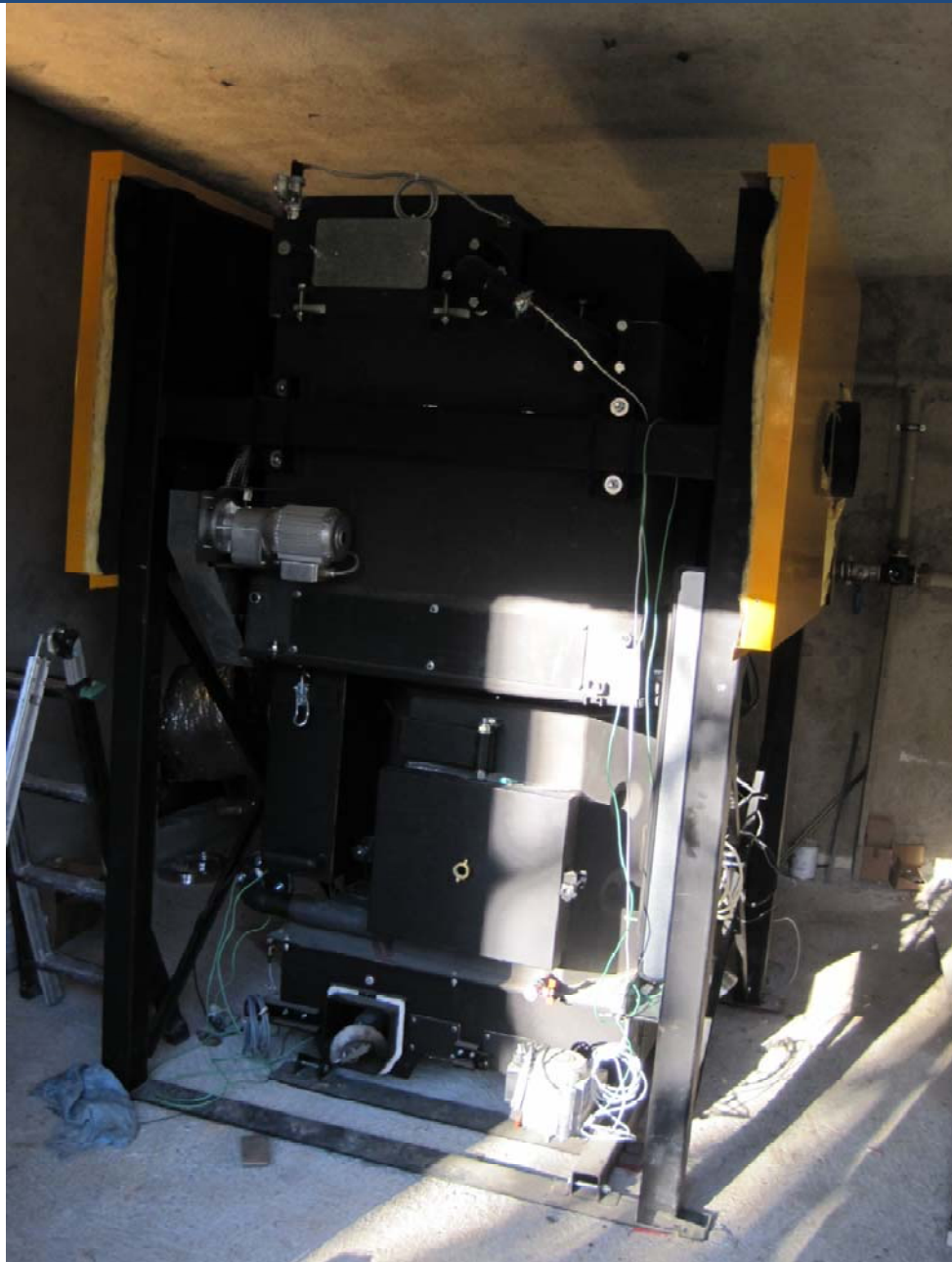
Caldera de biomasa
