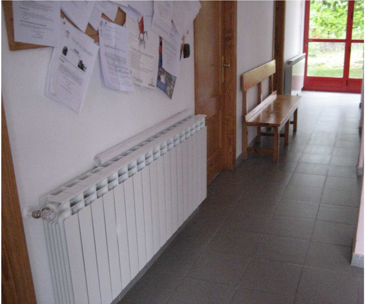
Interior de la Casa Consistorial. Radiador hall de entrada
