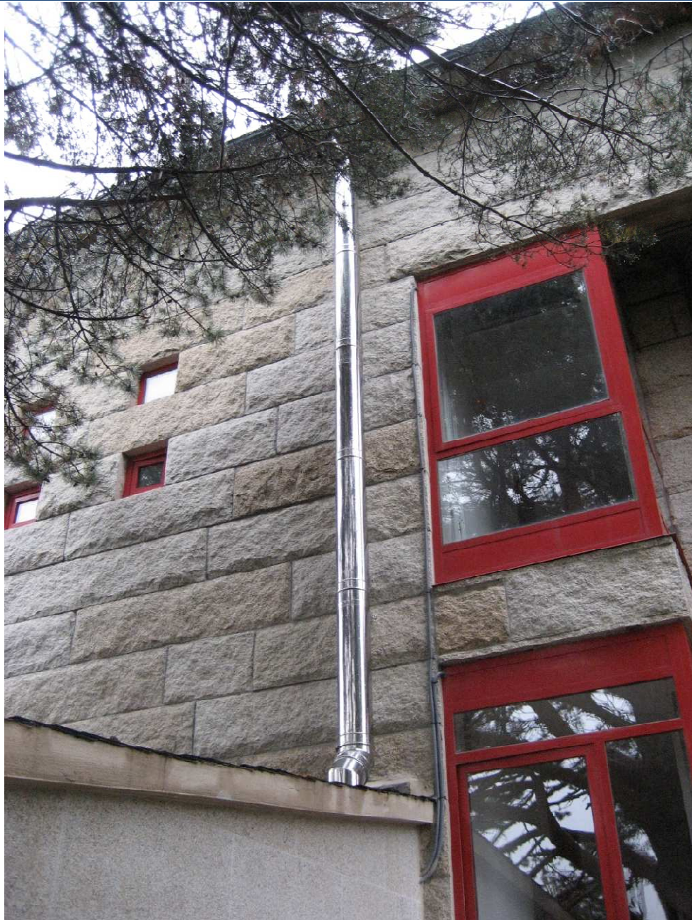
Exterior de la Casa Consistorial. Sala de Calderas. Detalle de la chimenea
