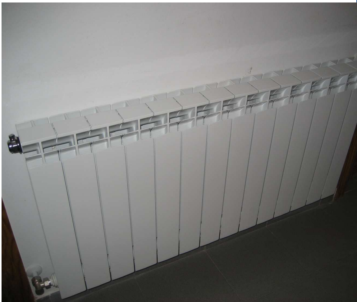
Interior de la Casa Consistorial. Radiador
