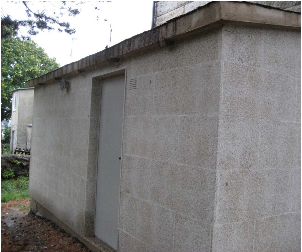
Exterior de la Casa Consistorial. Sala de Calderas
