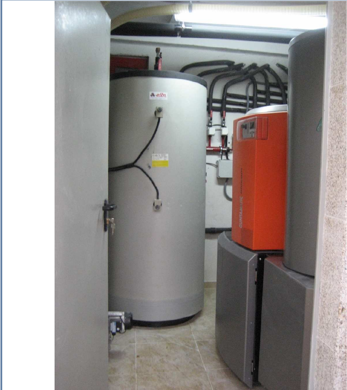
Interior de la Sala de Calderas
