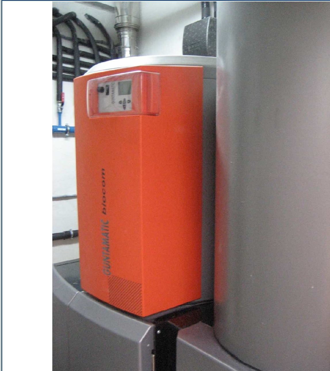
Interior de Sala de Calderas. Caldera de biomasa
