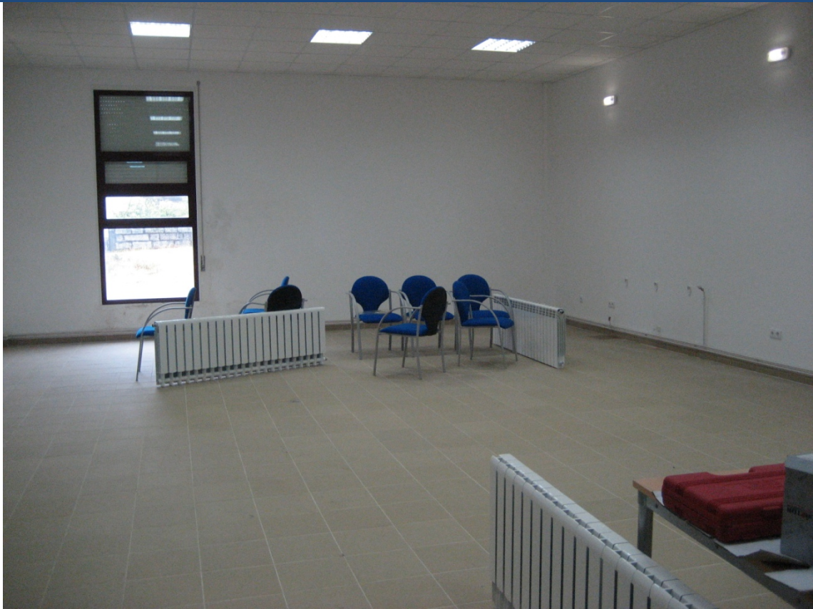
Radiadores pendientes de colocar durante las obras
