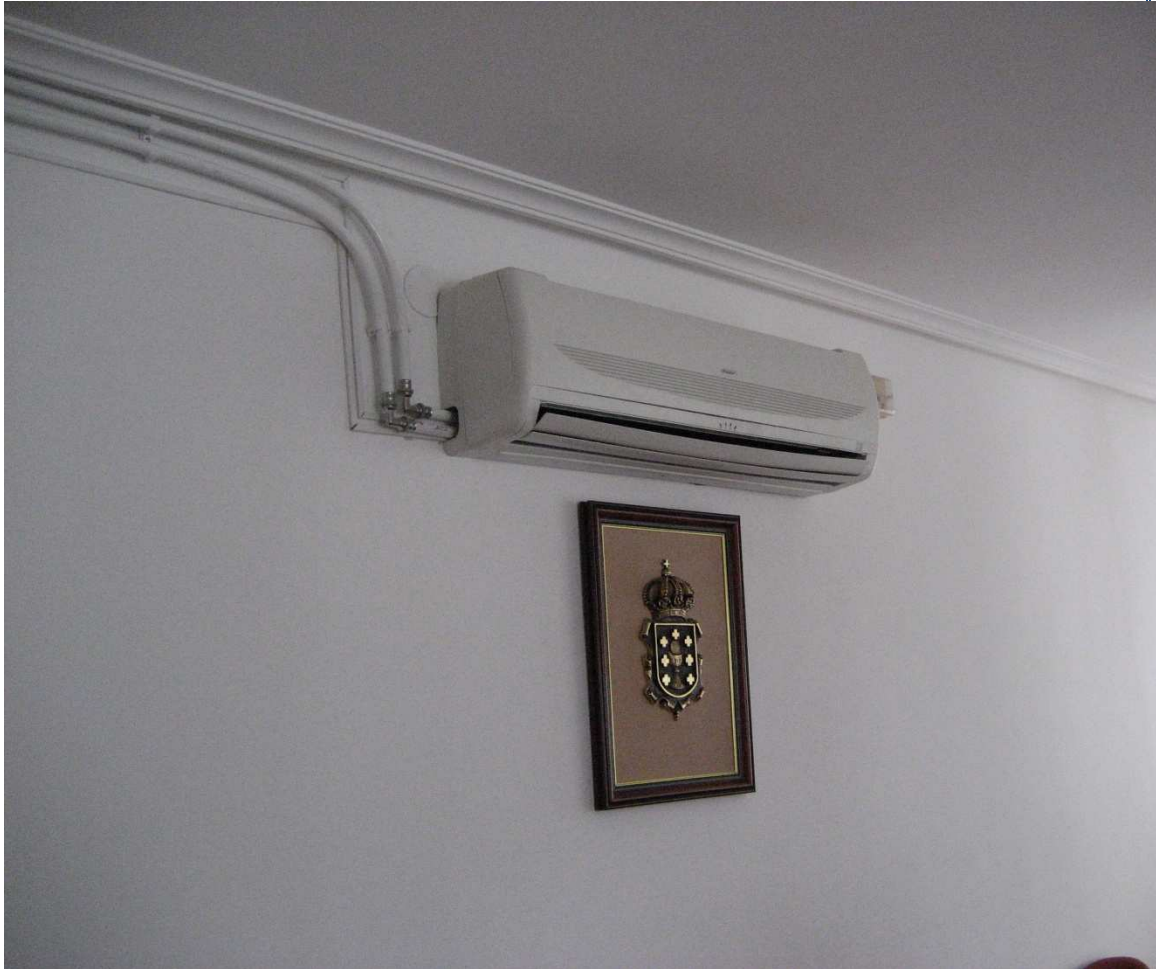
Interior de la Casa Consistorial. Fancoil Sala de Juntas
