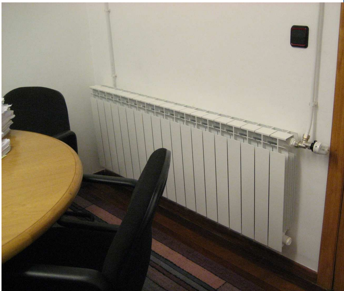
Interior de la Casa Consistorial. Radiador Alcaldía
