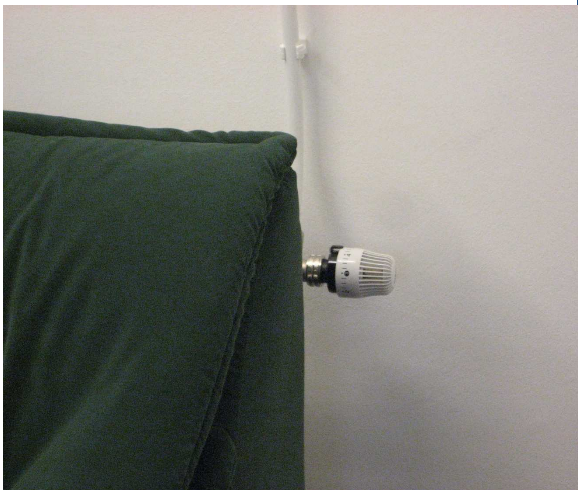
Interior de la Casa Consistorial. Radiador tapado por el mobiliario
